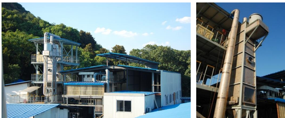
立式湿式静电除尘中试试验平台
