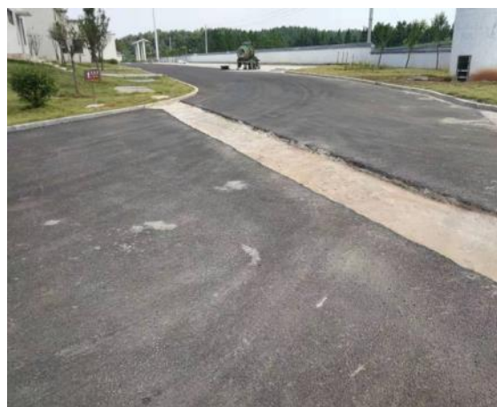
粗放施工导致掩蔽工程重新施工
