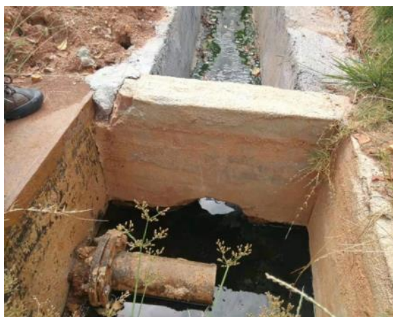
污水处理设施出水端标高偏低排水困难
