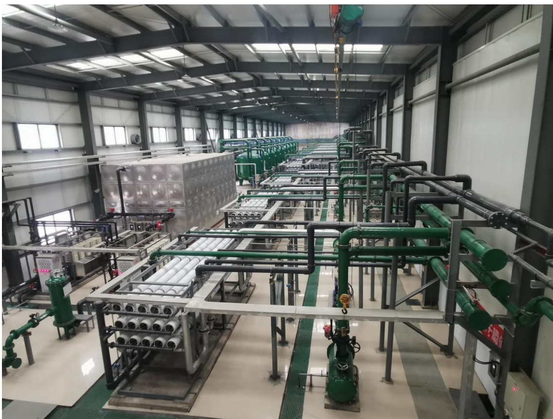
图 13 反渗透系统现场图
