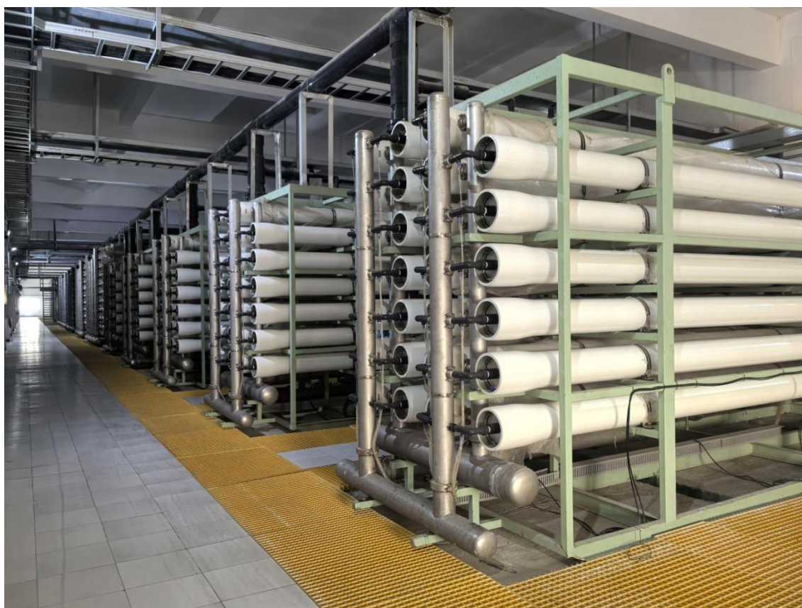
图 12 反渗透系统现场图
