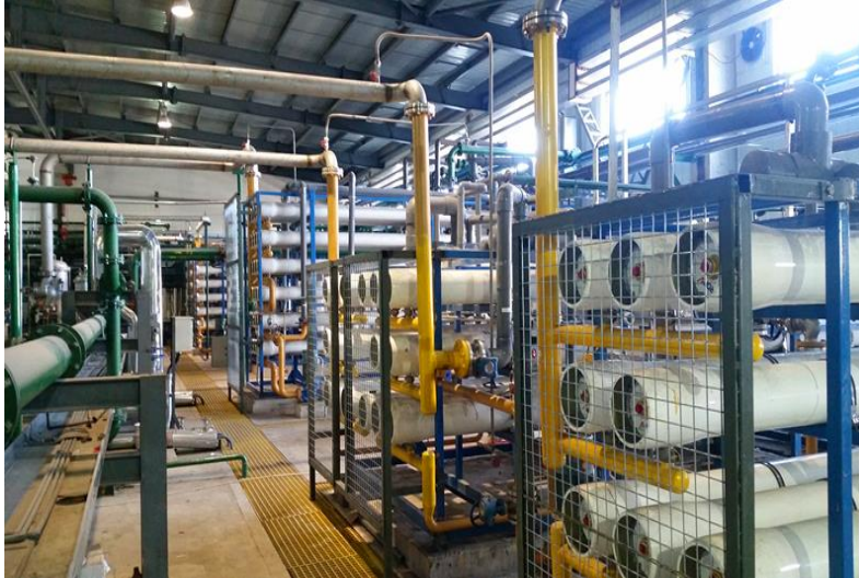
图 11 天钢生产废水系统深化改造工程-反渗透系统
