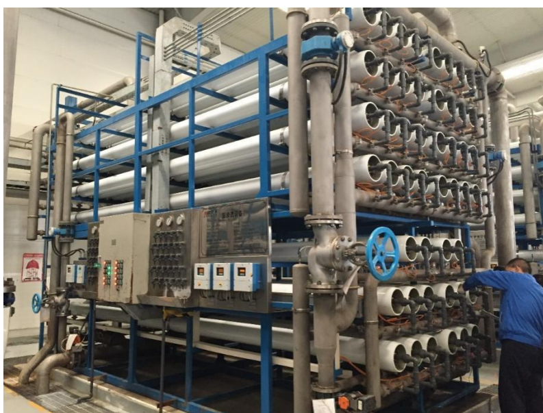
图 7 东区再生水厂反渗透装置
